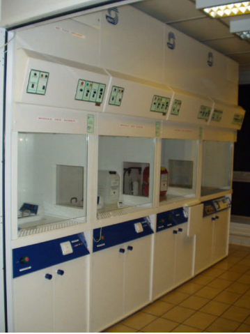
FLUX LAMINAIRE VERTICAL ligne de fabrication
